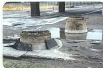
地中から突き出たマンホール
