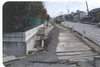
液状化で波打つ歩道
